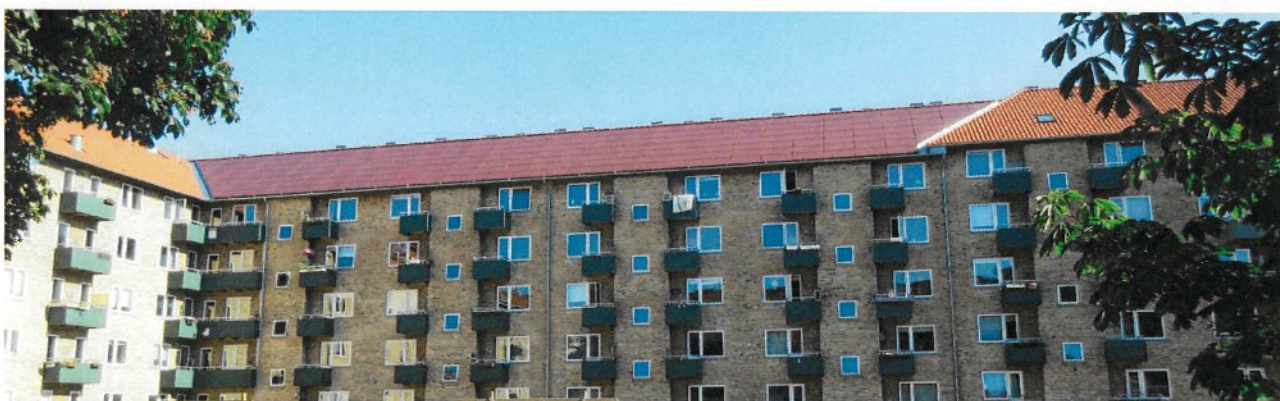
Andelsboligforening i NV med standardpaneler på heldækket tagflade med rød indfarvning. Den røde farve medfører, at tagfladen træder lidt tilbage og i en vis udstrækning falder ind med de omgivende tegltagflader. Også her omlægges el-systemet, så el-forbruget organiseres internt.
