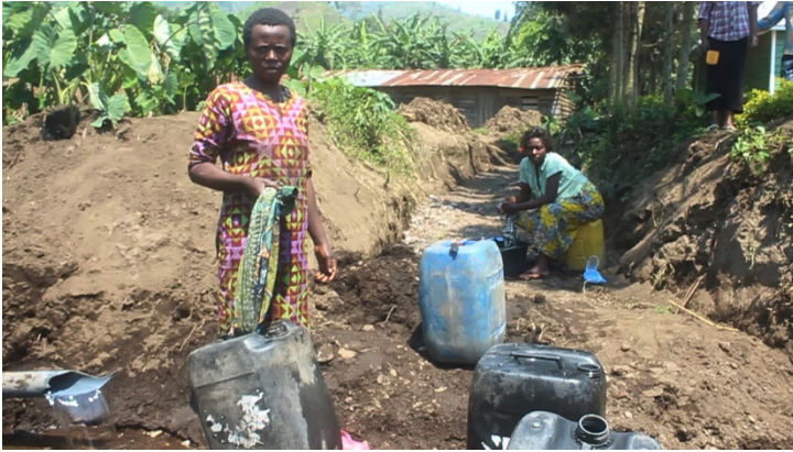
Figure 5 Conduite d'eau coupée par le ruissellement. à Buhunga
