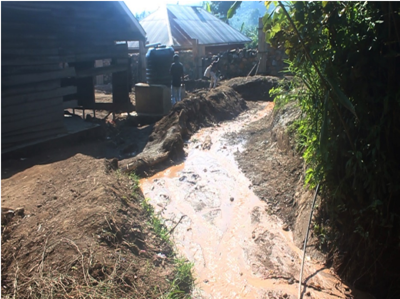
Figure 2 Batiment scolaire partiellement detruit
