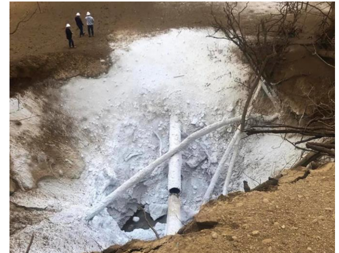
Et område omkring et knækket højtryks CO 2 -rør i USA. Den hvide tøris dannes tæt på bruddet, mens udløst gas spreder sig i atmosfæren 1 .
