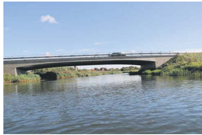
Der er fundet erosionskader på noget af den nuværende ringvejsbro i Ribe, men hvis det repareres, kan broen holde i mindst 25 år endnu. Arkivfoto: René Aunsbjerg Fogh
