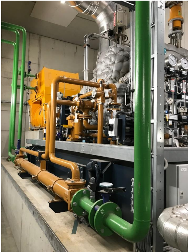
Stoom uit biomassa bij Brouwer in Balkbrug
