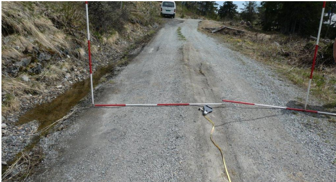
Vegbredde 3,25 veg 150 meter. Kjøreskader pga feilbrøyting.
