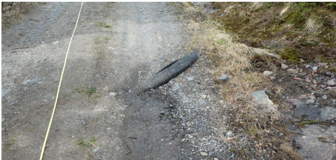
Defekt stikkrenne i bakken. Fjell i grøft
