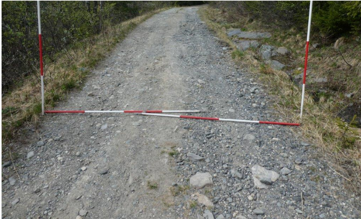
Vegbredde 3,25 meter. 20 % stigning, legg merke til fjell i grøft og store erosjonsskader.
