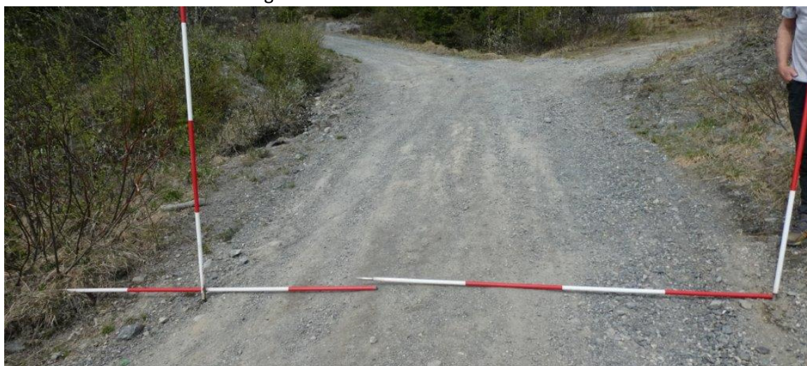
Vegbredde 3 meter ved 50 meter. 20 % stigning, erosjonsskader i bakken.
