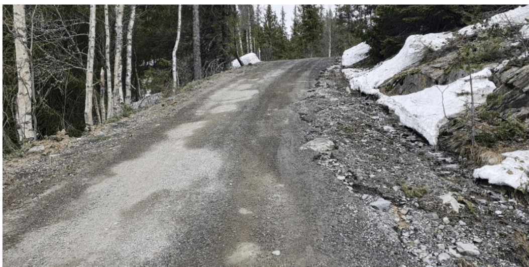
Erosjonsskader i Brattbakken etter vinterbrøyting.
