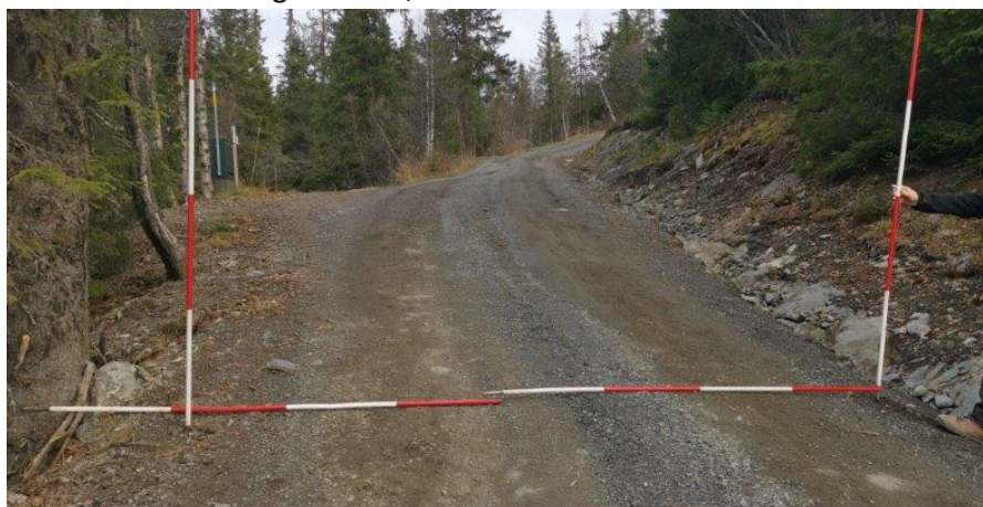
Vegbredde 3,4 meter etter 50 meter i Brattbakken. Mangelfull veggrøft i Brattbakken
