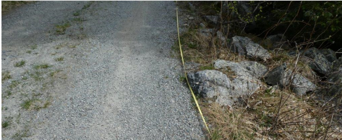
Blokk og stein i vegkant til hinder for brøyting.
