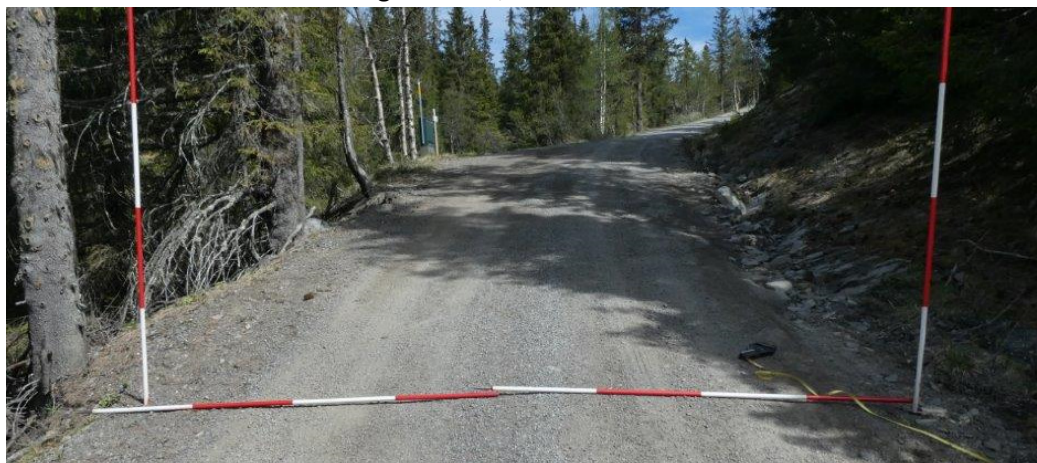
Vegbredde 3,75 meter etter 50 meter i Brattbakken. Mangelfull veggrøft i Brattbakken
