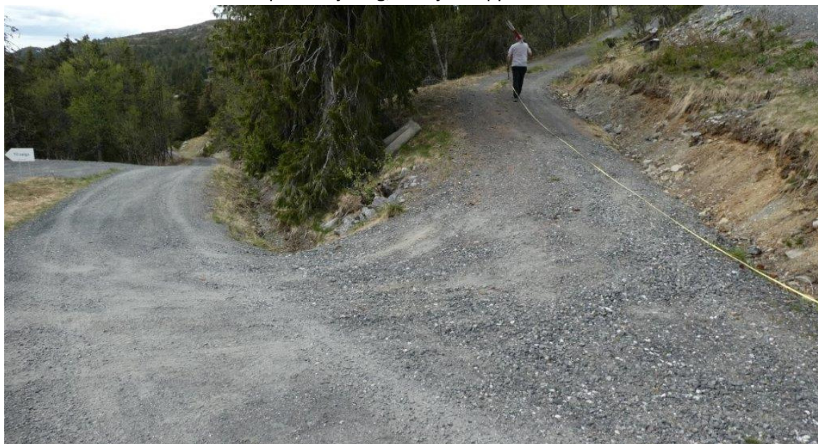
Meget krapp og bratt avkjøring
