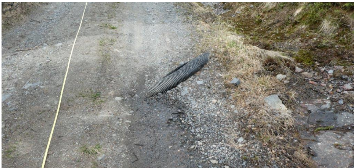
Defekt stikkrenne i bakken. Fjell i grøft
