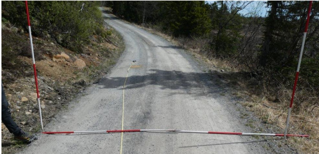
Vegbredde 3,6 meter ved 750 meter. Defekt stikkrenne.
