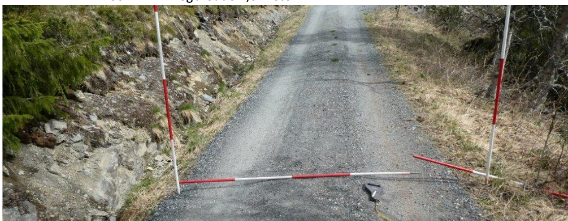
Vegbredde 2,6 meter veg 100 meter veg 5.
