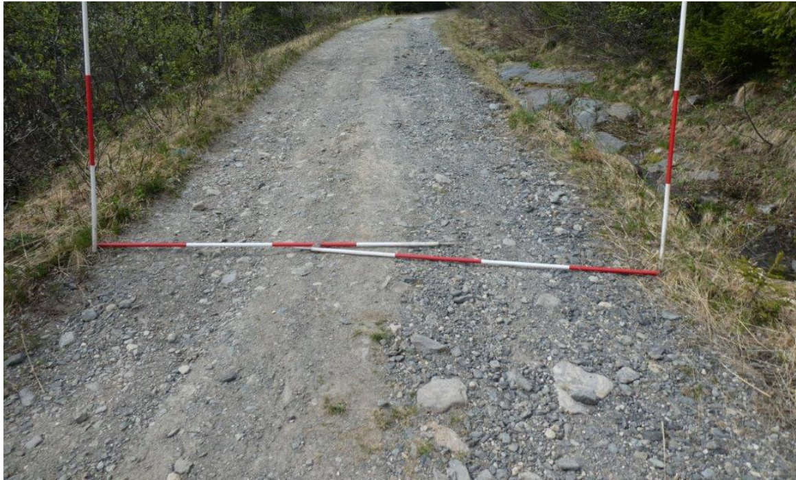
Vegbredde 3,25 meter. 20 % stigning, legg merke til fjell i grøft og store erosjonsskader.
