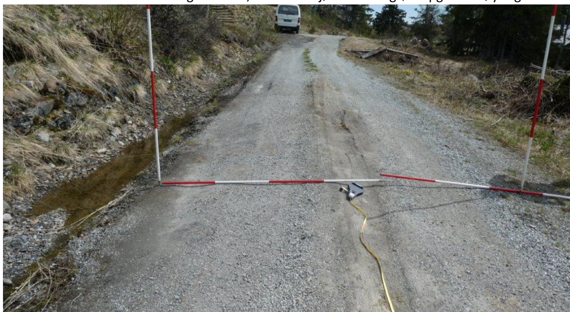
Vegbredde 3,25 veg 150 meter. Kjøreskader pga feilbrøyting.
