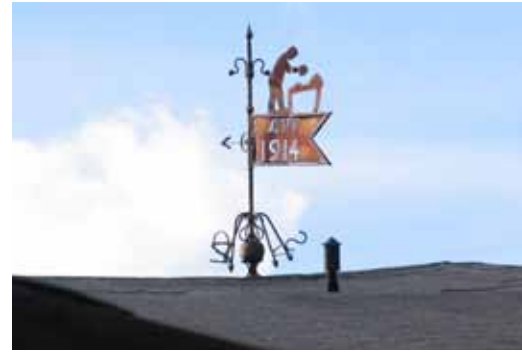
Vindfløjen fra 1914 forsvandt først fra taget ca. 2009, da bygningen henlå hærgnet og misligholdt.
