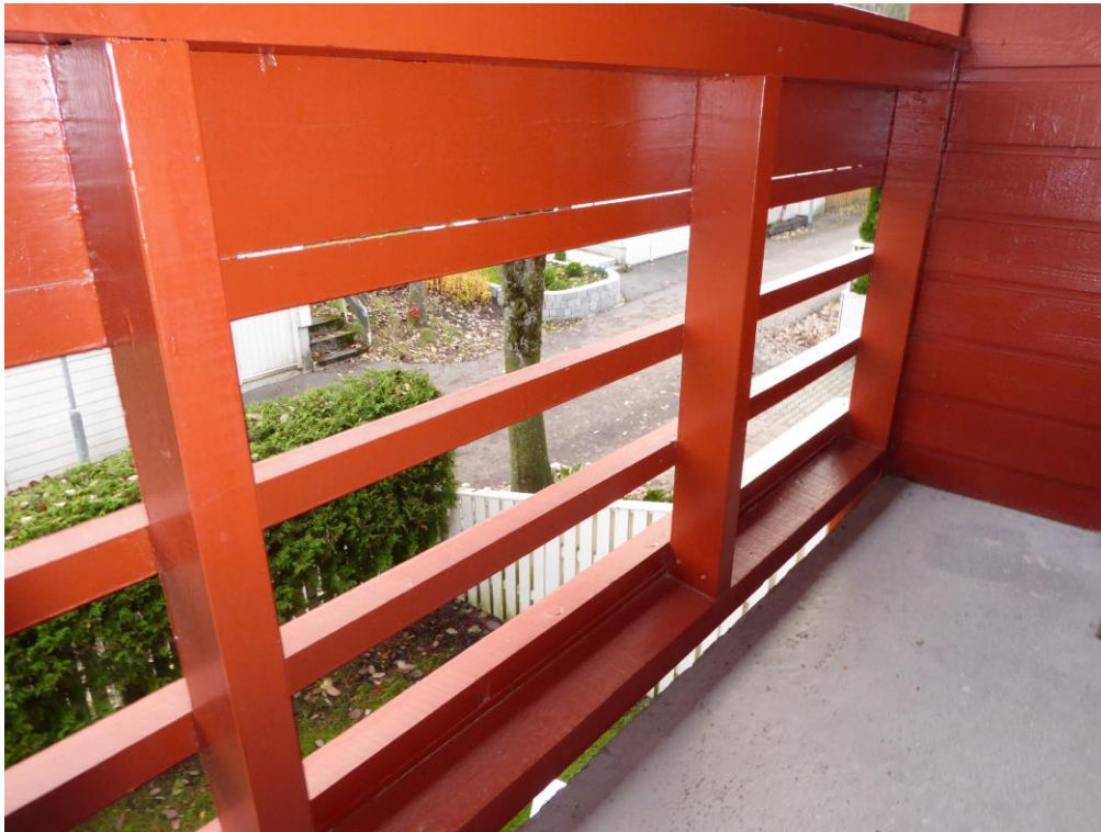
Bilde 8: Rekkverk med store glipper.
