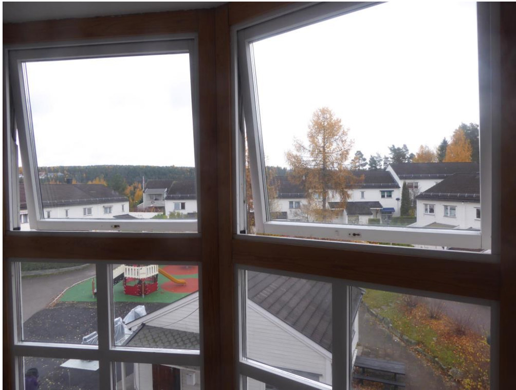
Bilde 3: Ødelagte håndtak i fellesareal
