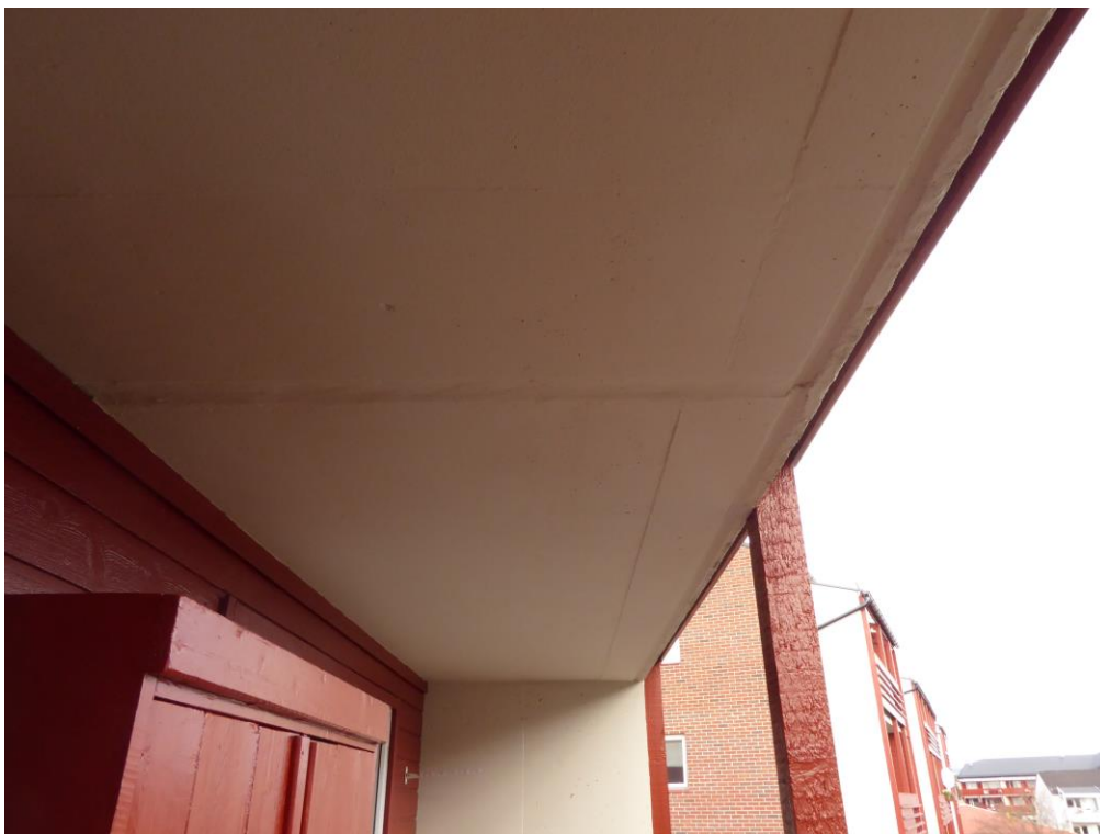
Bilde 9: Balkongunderside, med dryppnese i fremkant og godt vedlikeholdt.
