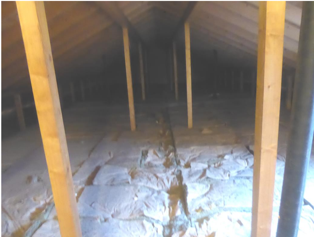
Bilde 5: Nedtråkket isolasjon på loft.
