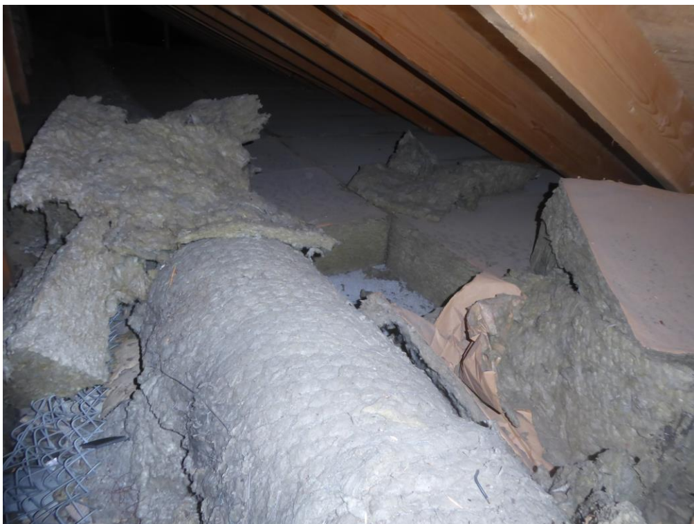
Bilde 6: Det er en del isolasjonsmatter som ikke ligger riktig på loftene.
