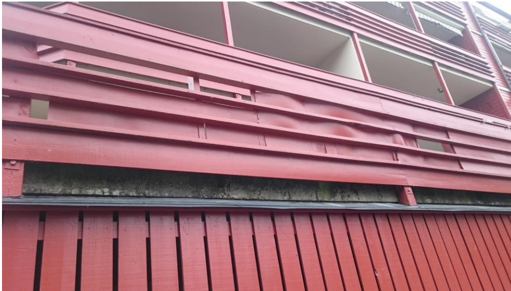
Bilde 10: Rekkverk sett fra utsiden, sannsynligvis forsøkt sikret mot klatring.
