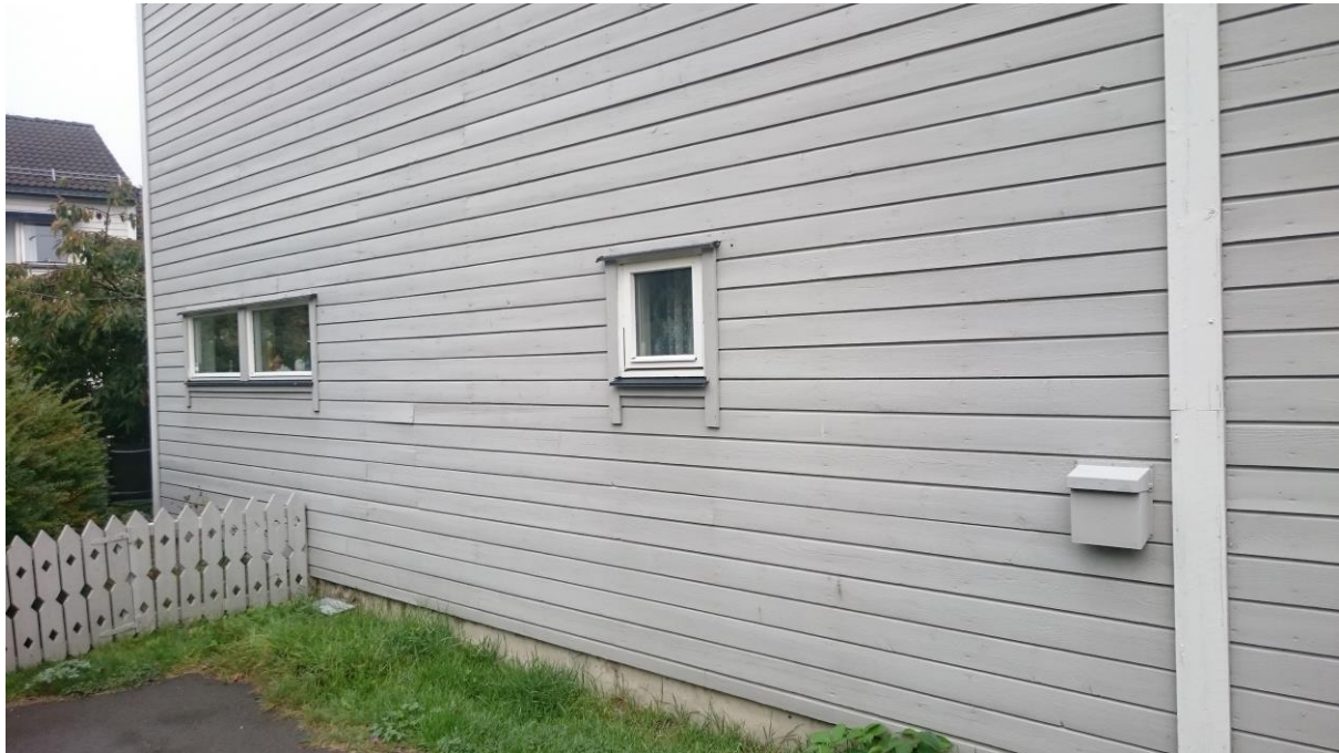
Bilde 12: Tilstanden på fasader er generelt god, men enkelte bord er stedvis vridd/sprukket.
