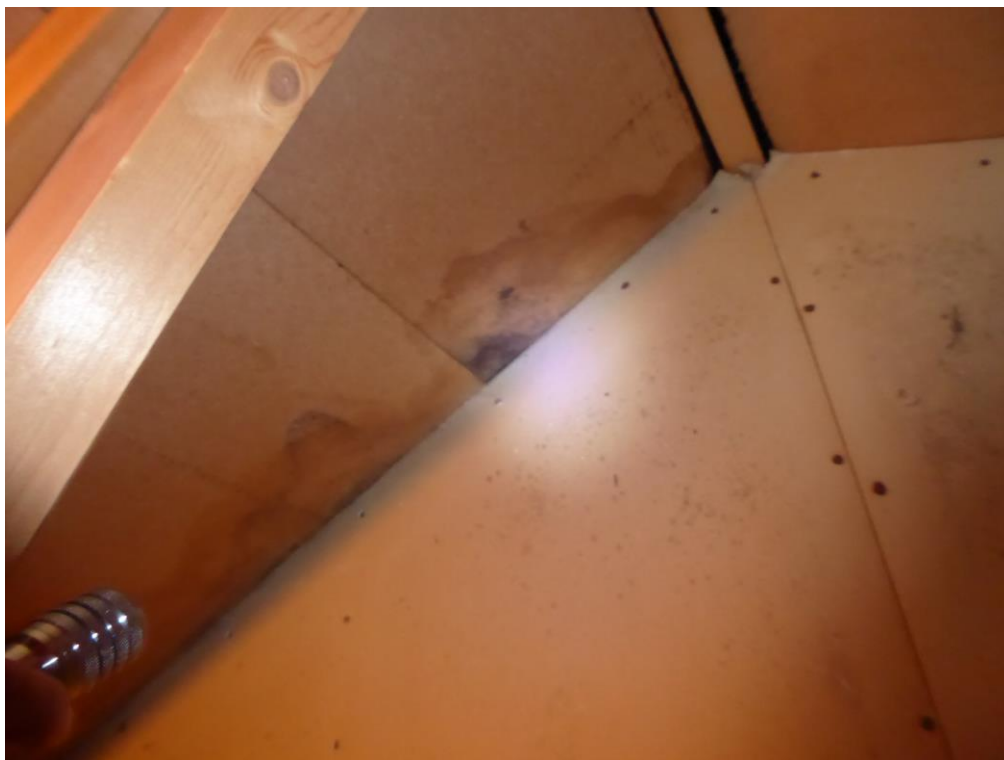
Bilde 17: Misfarging ved brannskillet indikerer problemer med dampettingen i etasjeskillet
