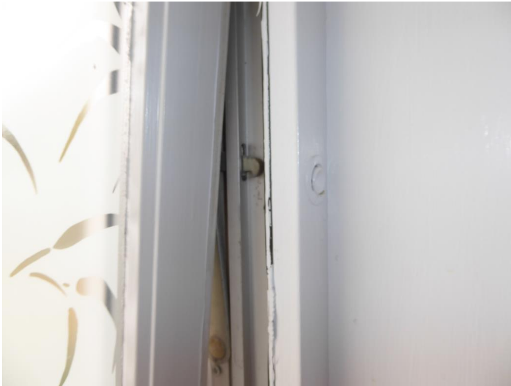
Bilde 14: Vinduene fra byggeår har slarkete hengsler og beslag og utette pakninger.
