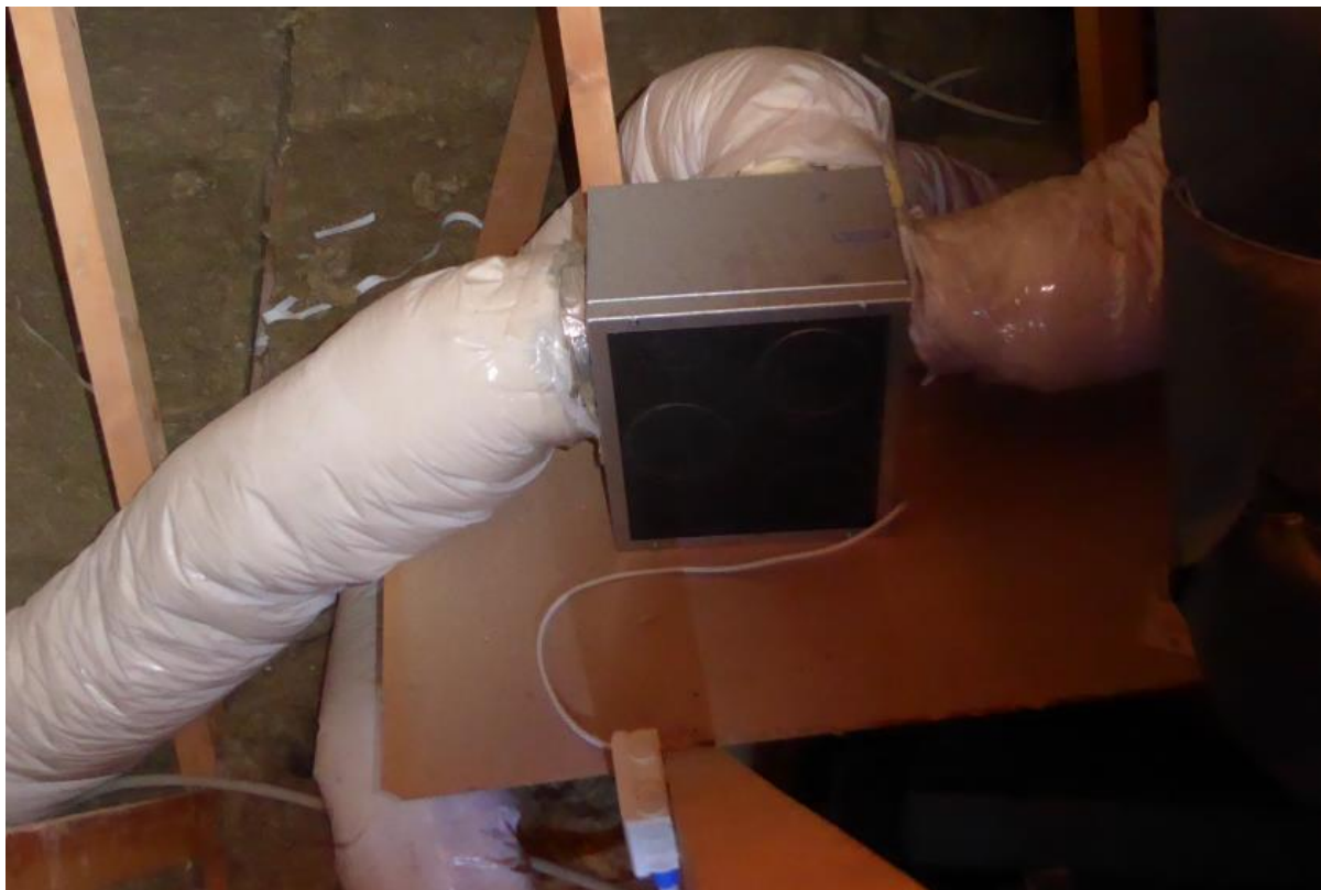
Bilde 18 - Ventilasjonsaggregat loft rekkehus
