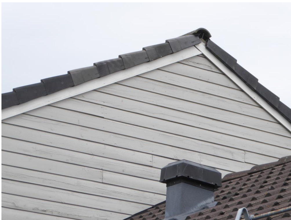
Bilde 13: Eksempel på gavlvegg over tak, panelen ligger for nære takflaten og begynner og bli oppsprukken
