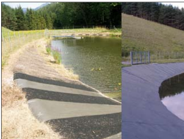
Abb. 19: Das Absatzbecken links jetzt mit Vliesstreifen als Ausstiegshilfe - rechts noch ohne und für viele Tiere tödlich.
