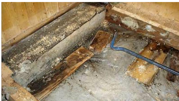
Skade i kjellergulv. Foto: Anticimex
