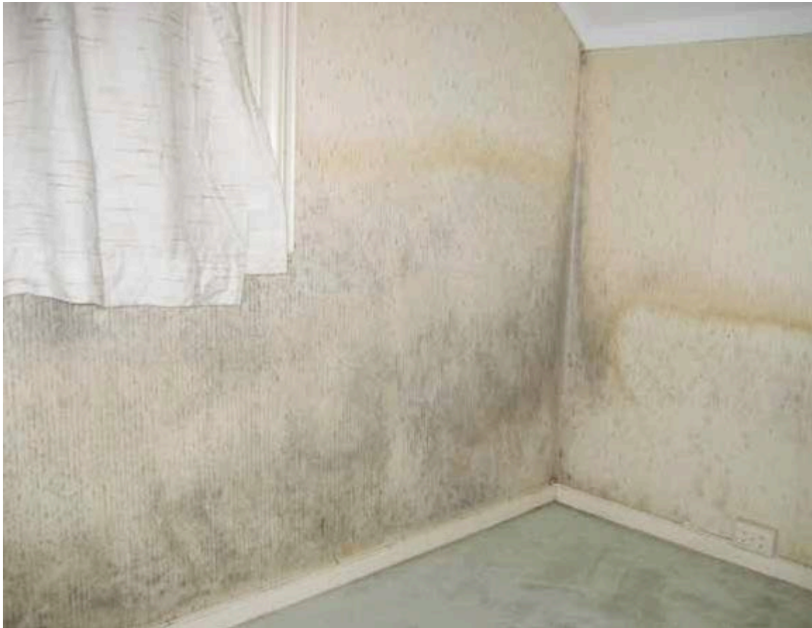
Figur 22. Foto: Kai Gustavsven. Rom uten isolasjon og fuktsperre etter bruk.
