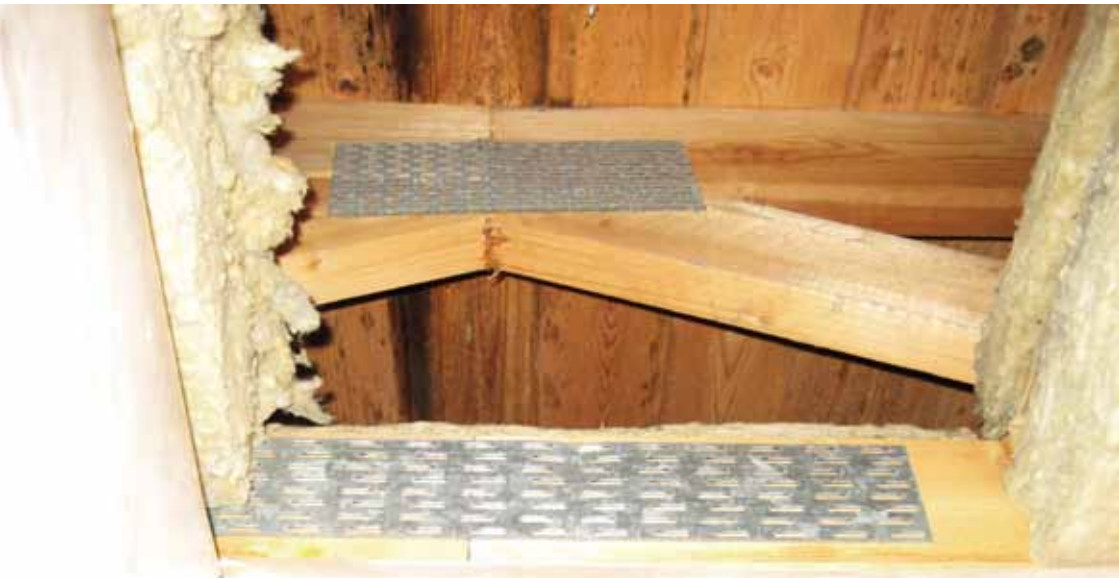
Kondens og svartesopp på kaldt yttertak.
