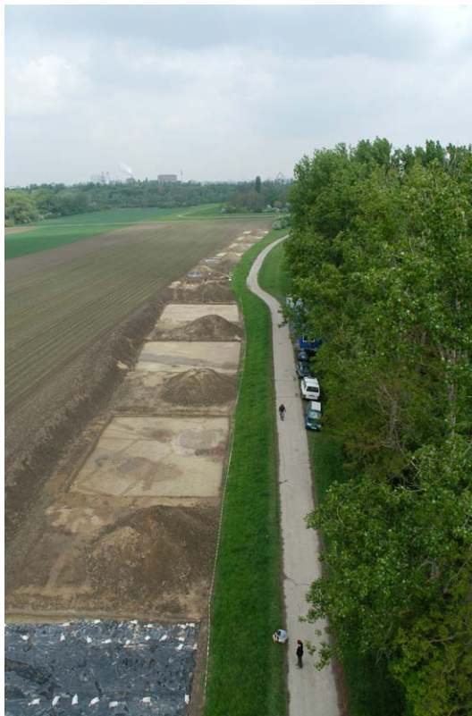
Abb. 3 Blick von Süden über die Grabungsfläche im Bereich des späteren Deiches. Die Ausgrabung begann mit dem Abbagern des Oberbodens (ca. 40 cm Humus), eine Arbeit, die von einem erfahrenen Baggerfahrer mit einem Bagger mit glattem Böschungslöffel durchgeführt wurde, um eine möglichst plane Fläche zu erhalten. Aufgrund des Abraum-Lagerungsproblems wurde die Fläche alternierend aufgedeckt, so dass zwischen zwei offenen Grabungsschnitten jeweils eine gleich große Fläche zur Lagerung des Oberbodens zur Verfügung stand.
