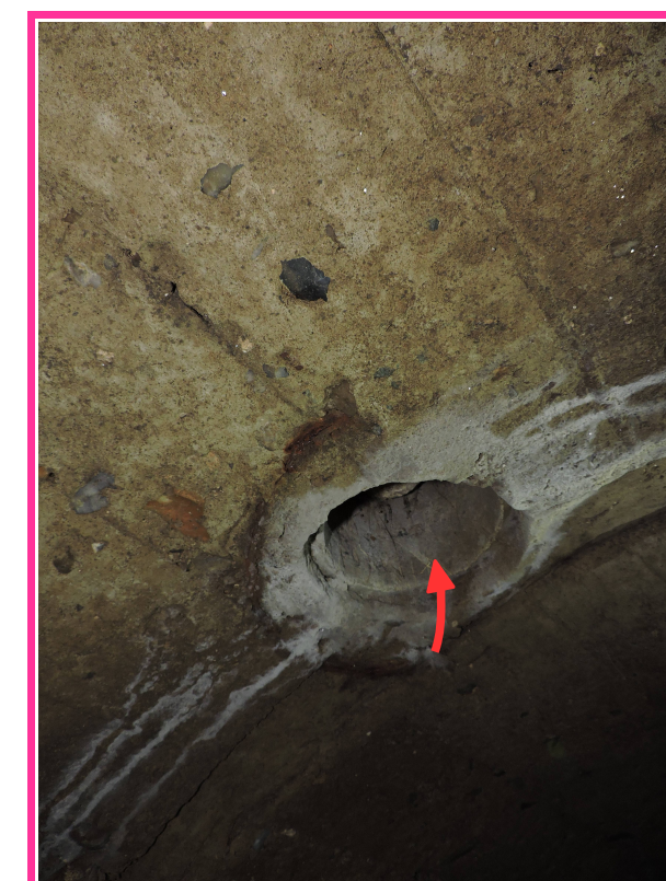
Bouche d'aération / ventilation
