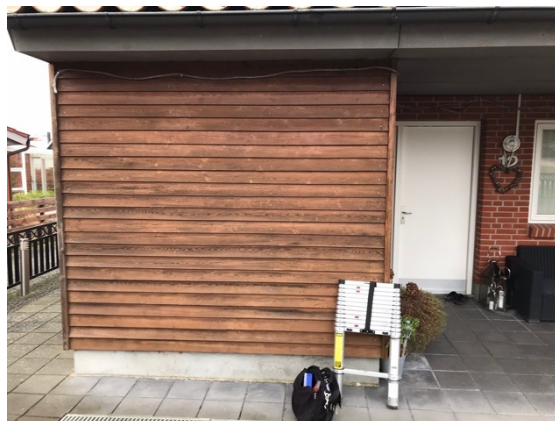
Træbeklædning ved udhus / redskabsskur trænger til malerbehandling
