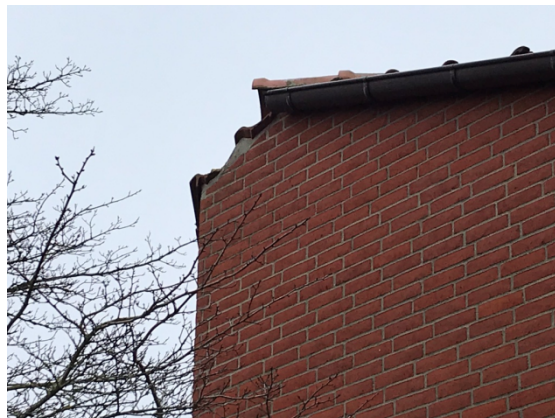
Der mangler inddækning ved gavl i hus nr.
