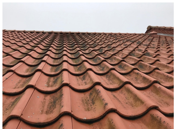
Tagkonstruktionen / tagbeklædningen har enkelte steder misfarvning af alger / mos som løbende skal afrensnes for at forlænge tagbeklædningens levetid.
