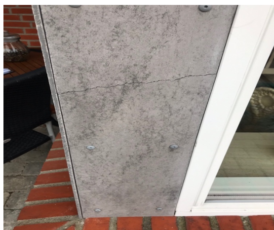
Inddækning skal demonteres og udskiftes med ny inddækning.
