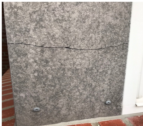
Inddækning af søjle mellem facadeelementer er flere steder revnet og kan medføre utætheder og fugtskader
