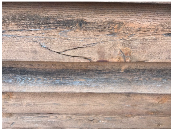
Defekte brædder skal udskiftes for at bevare
