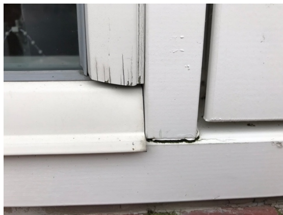
Tydelig revne mellem lodpost og underkarm
