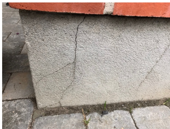
Revner i sokkel ved hjørne under bærende søjle. Det kan ikke udelukkes at revner er forårsaget af sætningsrevner.
