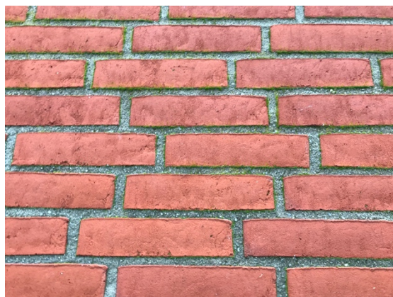
Misfarvet murværk som skyldes længere tids opfugtning.
