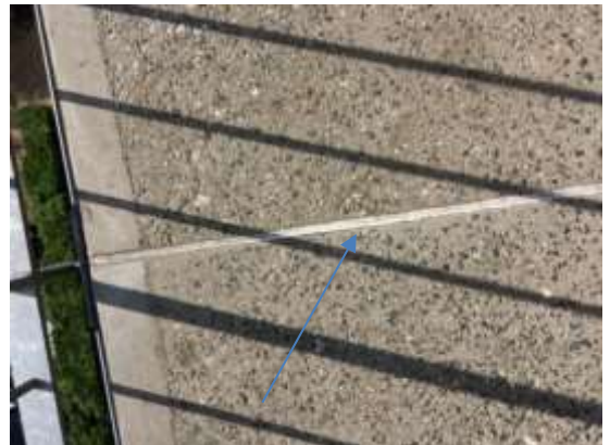
| Defekt fuge ved betondæk
