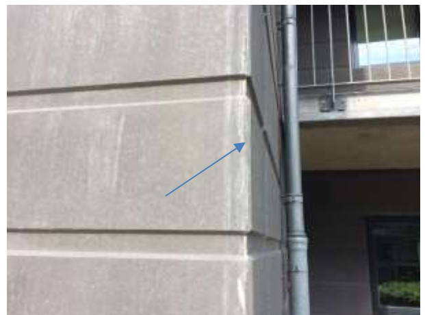
| Beton facade med revner ved hjørne
