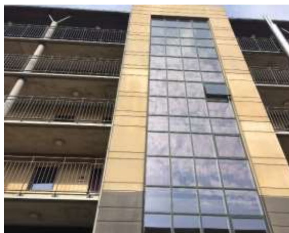
| Indgangsparti med defekte fuger og vinduer.
