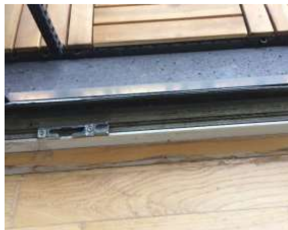
| Vandskade ved altandør med defekte gummilister.
