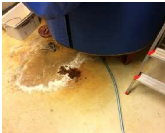
| Varme installationer med utætheder
