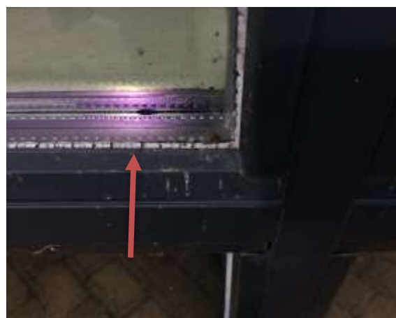
| Glasbånd i vindue som defekt og har mistet elasticiteten
