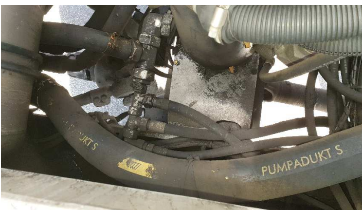
Testet sving og besiktiget svingkrans fester.
