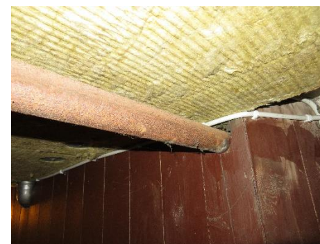
Gasledning med overfladerust uden maling
