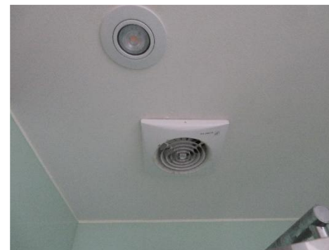
Ventilator på badeværelse
