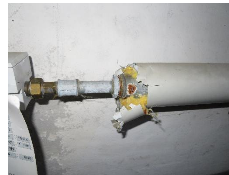
Tæring på galvaniseret rør i kælder
