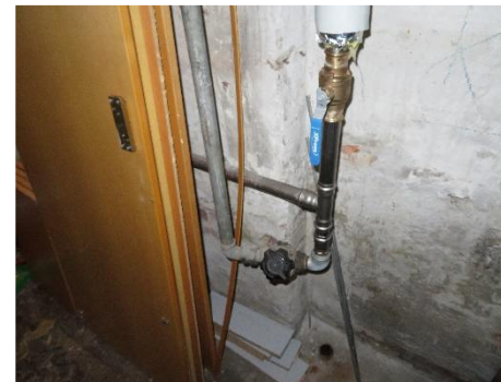
Ældre galvaniseret og ny rustfri vandinstallation
