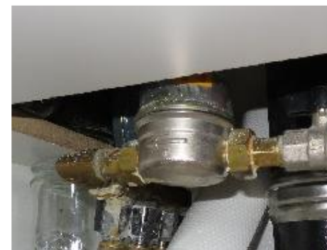
Varmtvandsmåler med tæring på fittings
