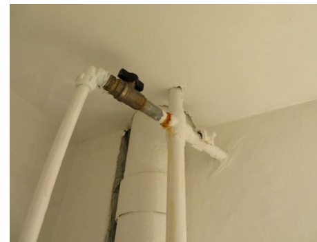
Ældre installation med tæring på toilet.
