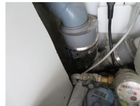
Afløb og faldstamme i køkken
