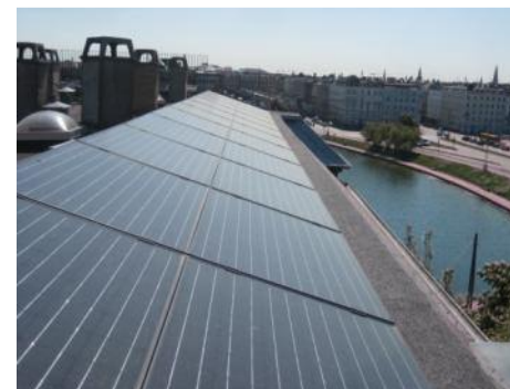
Eksempel på solcelleanlæg
