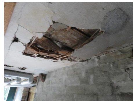
Huller i rørpuds
