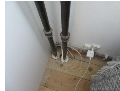
Var mestigstreng i lejlighed
