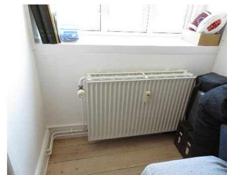
Radiator i lejlighed
