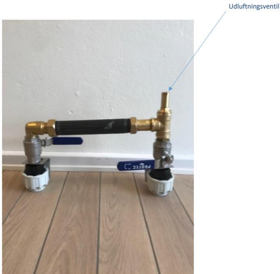
Figur 1/Haner og udluftningsventil som sidder i vandmålerbrønd. Hvor det sorte rør sidder, sidder jeres vandmåler.
