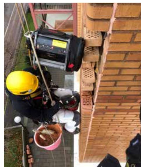
Murning, frostsprängda tegelstenar
