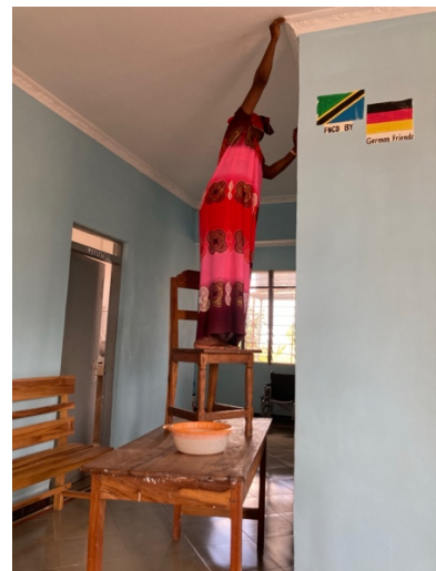
Wespennester werden entfernt
