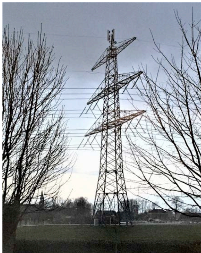
Afb. 6 220 kV mast tussen Sauwerd en Klein Wetsinge, in de top voorzien van antennes en schotels voor mobiele telefonie. Foto Bé Kuipers
