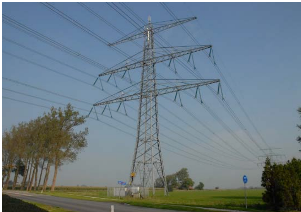
Afb. 4 220 kV mast ten noorden van Sauwerd, rechts van de Provincialeweg. Vlak naast de mast, rechts, het bosje van de Janushoeve. Foto: hoogspanningsnet.com
