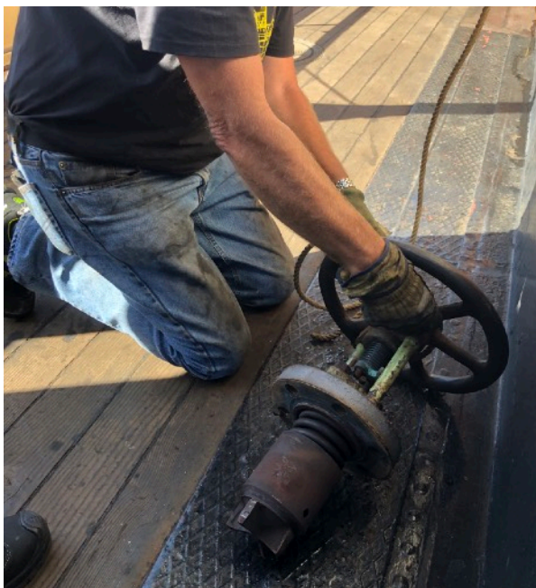
Lars med den defekte ventil
