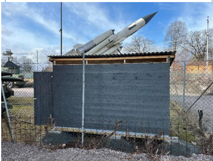
KI 1500 är förrådsboden uppsatt, återstår knutbrädor, vindskivor och ramp samt målning en varm och solig dag.
