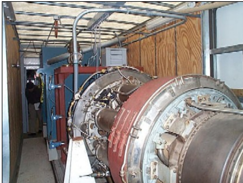
Proteus installationen i den mobila anläggningen
