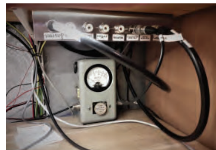
BILD 2: Antennväxeln drifttagen. Viktigt att dokumentera vilken radio som finns bakom respektive kontakt. Detta för att det skall bli enkelt att använda och att inga misstag görs.
