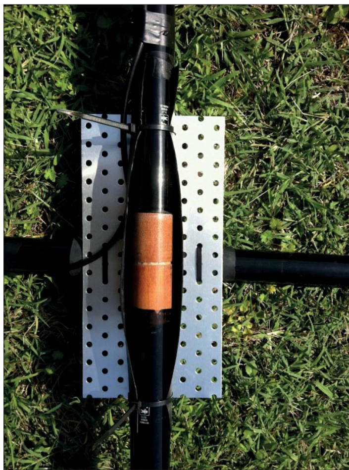
Bild 5 – Spridarna / bomen fästes på lämpligt sätt till masten. Här har en hålad metallplåt använts för att med buntband fästa dom olika delarna. Detta enligt F4BKV. Den ljusa delen är ett skarvstycke för att hålla ihop dom två bomdelarna i mitten.
