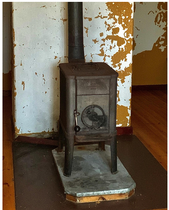
Gjutjärnskaamin i sovrummet
