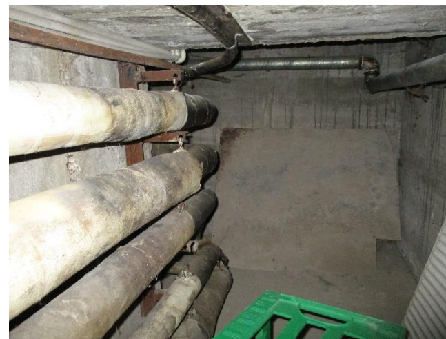
Rørføringer ved ingeniørgang.
