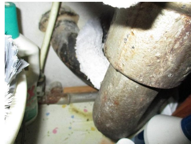
Tæring på brugsvandsrør i køkkenskab.
