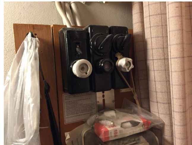
Ældre sikringsgruppe i lejlighed.
