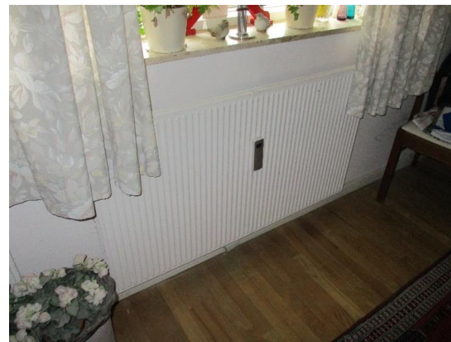
Radiator i lejlighed.
