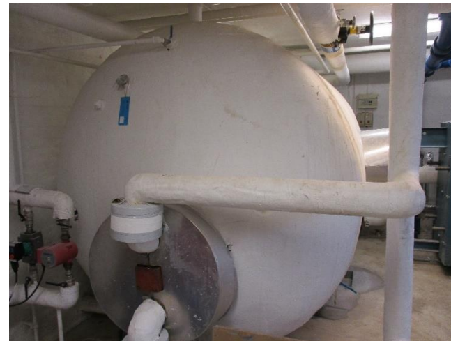
VVB i varmecentral Blok 3A.
