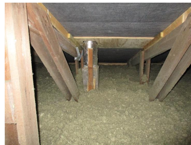
Nyere kanal med isolering.
