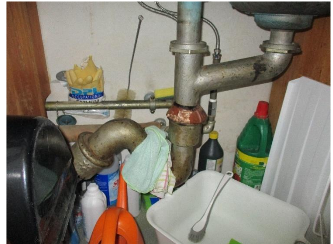
Afløbsinstallation under køkkenvask.
