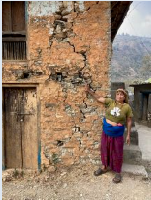
Vi såg många helt förstörda hus. Och en del med farliga sprickor.
