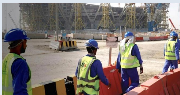
Nepalesiska arbetare på en byggarbetsplats i Qatar, där fotbolls-VM kommer att hållas senare i år.
