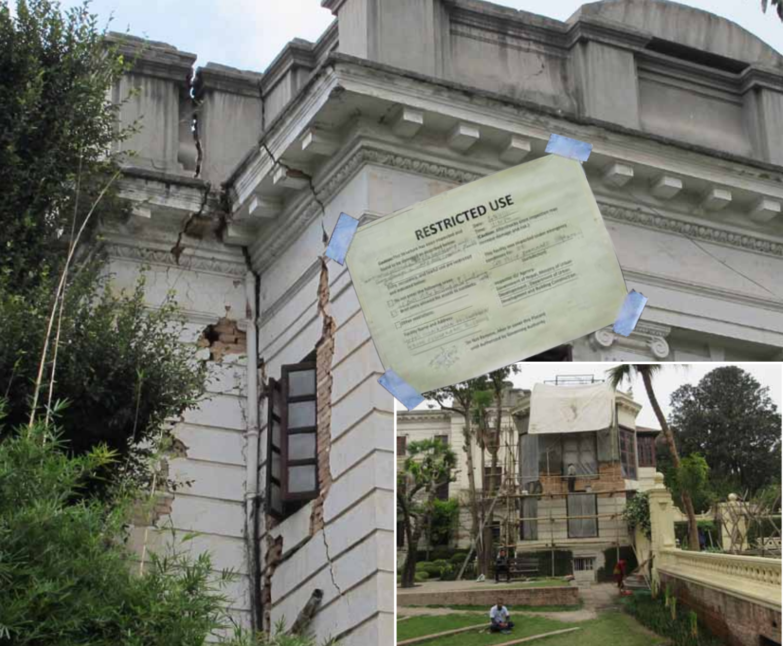
Jordskælvet gav store revner i Kaiser Mahal, der fik en 'yellow sticker'
