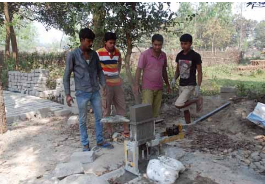
Inderne undervises i brugen af murstensmaskinen. T.v. ses det færdige resultat. Disse byggeblokke er langt billigere at fremstille end brændte mursten af ler. Selvfølgelig under forudsætning af, at produktiviteten er høj. Er den det, kan fire mand producere ca. 700 byggeblokke om dagen.
