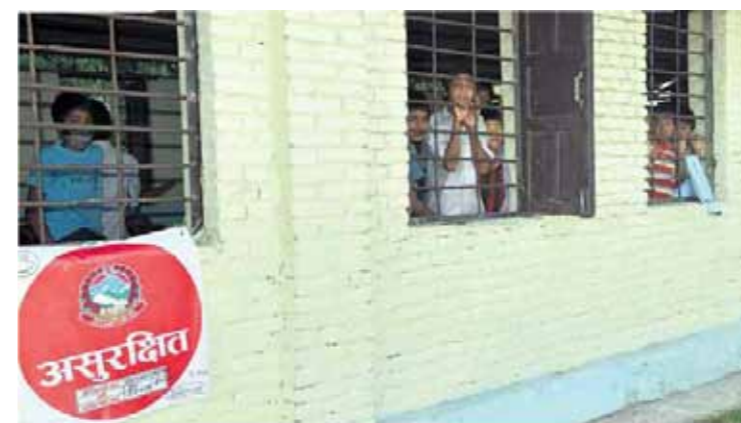
Myndighederne har sat bygningskyndige i gang med at kontrollere bygningernes tilstand. Bygninger, der skal rives ned, får en rød mærkat. Her er det en skole, der dog mod reglerne benyttes alligevel. Foto: Madhusudan Gugarain, República
