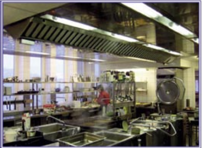
Hette met tilluftstak og lys monterert i restaurantkjøkken
