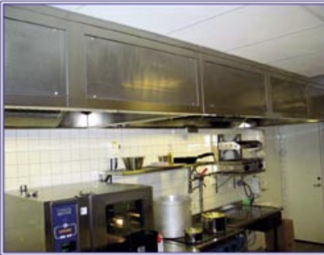
Hette met tilluft, benyttet på et mindre skolekjøkken
