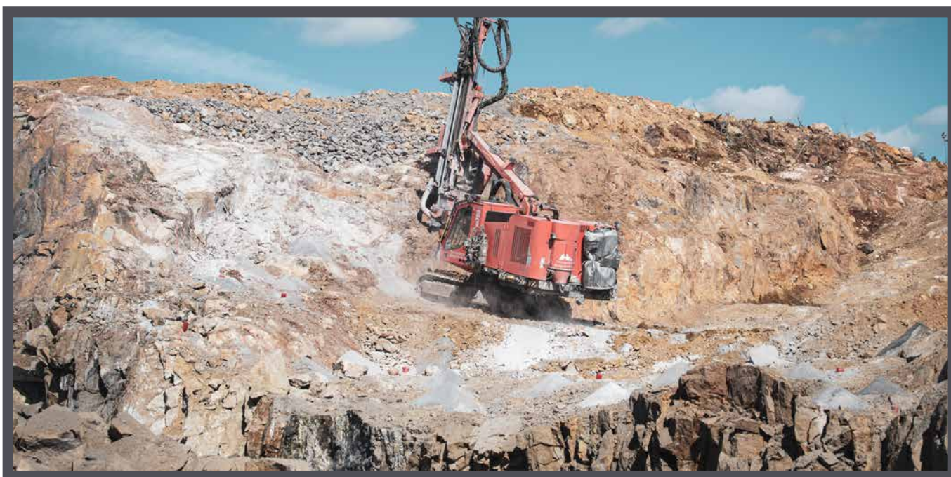
Pegros portföljbolag Nordisk Bergteknik och dess dotterbolag Norrbottens Bergteknik under arbetet med bergsborring på Markbygdens vindkraftspark
