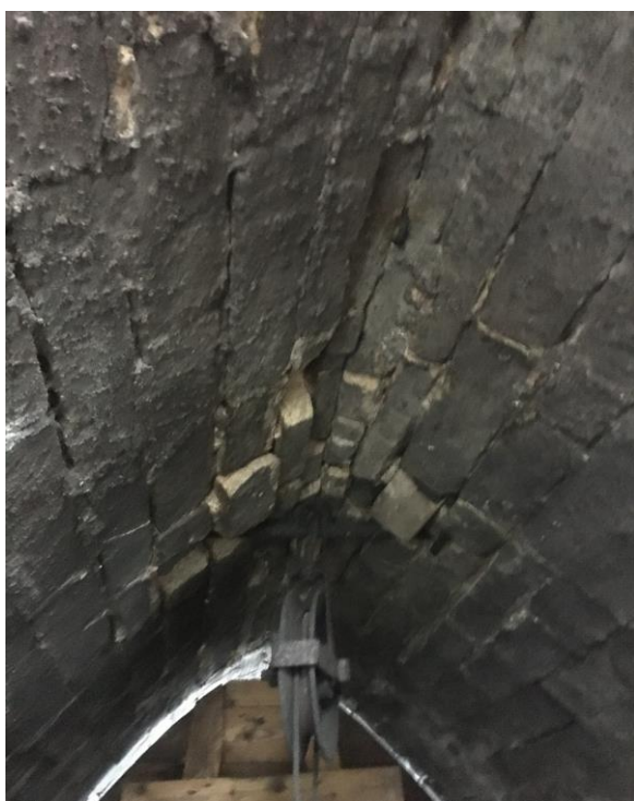
Valvet i taket på luckplanet.
