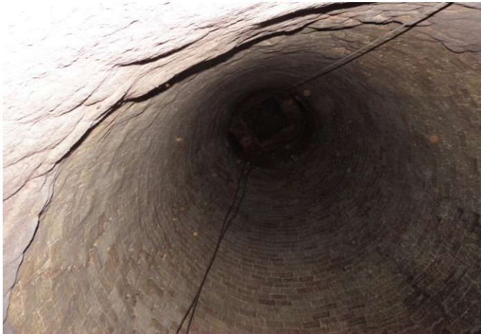
Skorstenens nedre del med lätt slammad tegelyta som är i gott skick upp till luckplanet.
