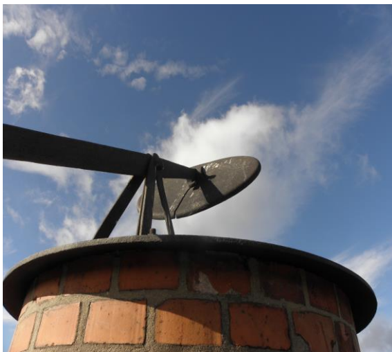
"Topplocket" med sprickan rakt igenom.
