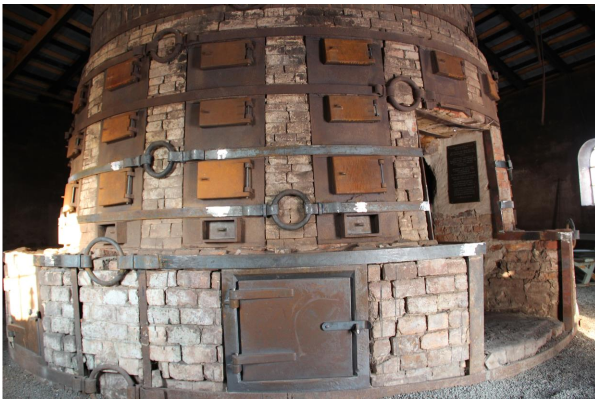
Här en bild från 2011 då man bytte ut några järnband runt skorstenens nedre del.
