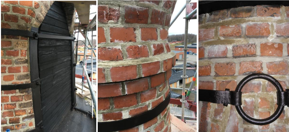
Träluckorna har målats med linolja. Nya kalkbruksfogar har svärtats med pigmenterat kalkvatten.
