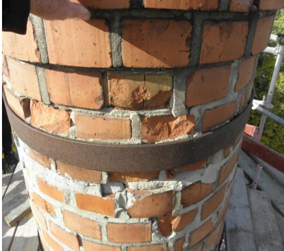
Svårare tegelskador i toppen.
