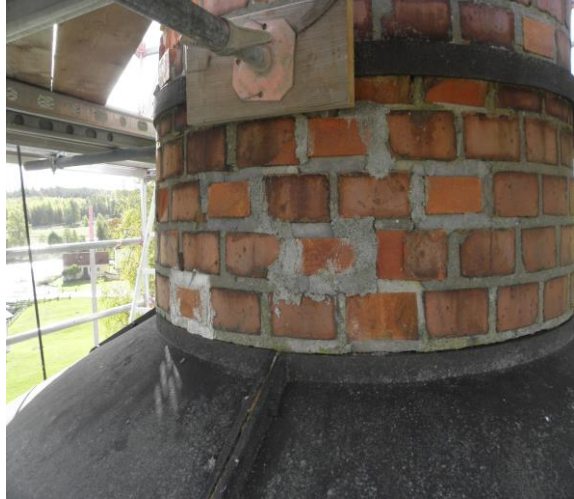
Avtäckning av gjutjärn/järn vid skorstenens avtrappning.. Halva skorstenen stod utan bindande fog.
