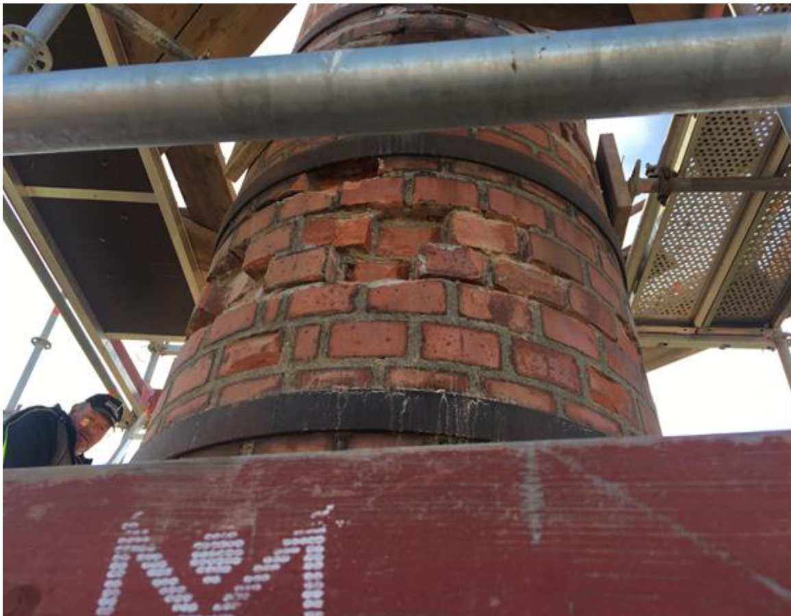
Många stenar var frostskaade.
