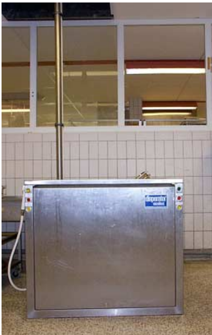
Bild 2. Processorn vid Medirest (även kallad GT-system). Rörledning för vertikal transport av avfallet ses bakom processorn. Foto: Mats Edström
