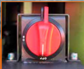
Interruptor de corte de la batería
