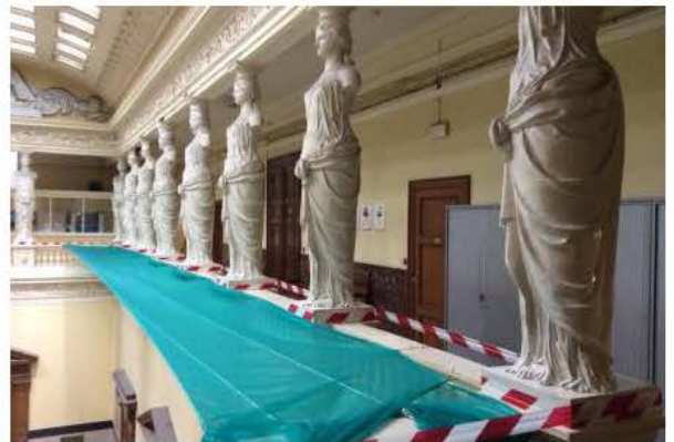
Palais de justice de Mons: une bache tendue pour empêcher le plafond de tomber sur la tête des gens...
