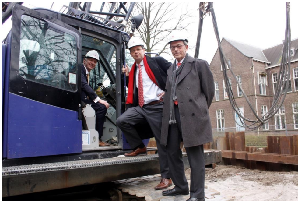
De eerste paal werd geslagen door Willem te Beest, vicevoorzitter van het College van Bestuur, en de wethouders Pieter van Woensel en Robert Strijk
