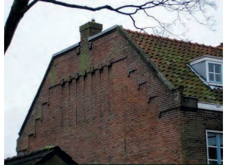
Detaillering metselwerk aan de kopse kant van sommige huizen aan de Lijsterstraat
