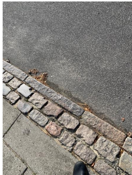
Det er området mellem kantsten og asfalt, der er særlig kritisk at holde rent, for at undgå skader på vore kloaker.
