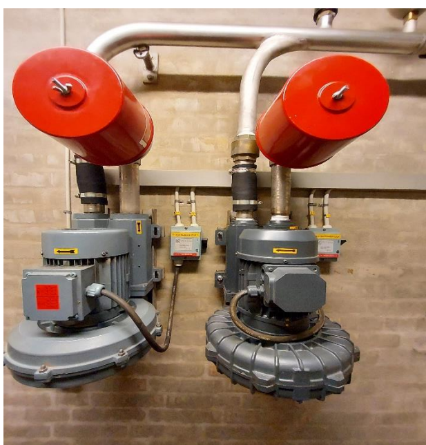
Foto 11 Luftblæser til iltningstank. Blæserne er placeret i rummet med rentvandstanken.
