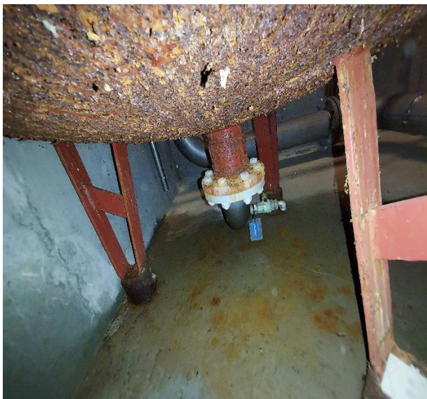
Foto 10 Undersiden af iltningstanken, opmærksomhed på tankens tilstand, henblik på gennemtæring. Gulvet under tanken er fugtigt, afledes til sumpebrønd ved siden af iltningstanken.
