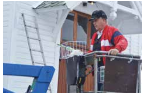
Per Åge Skretting på veg opp i liften.
