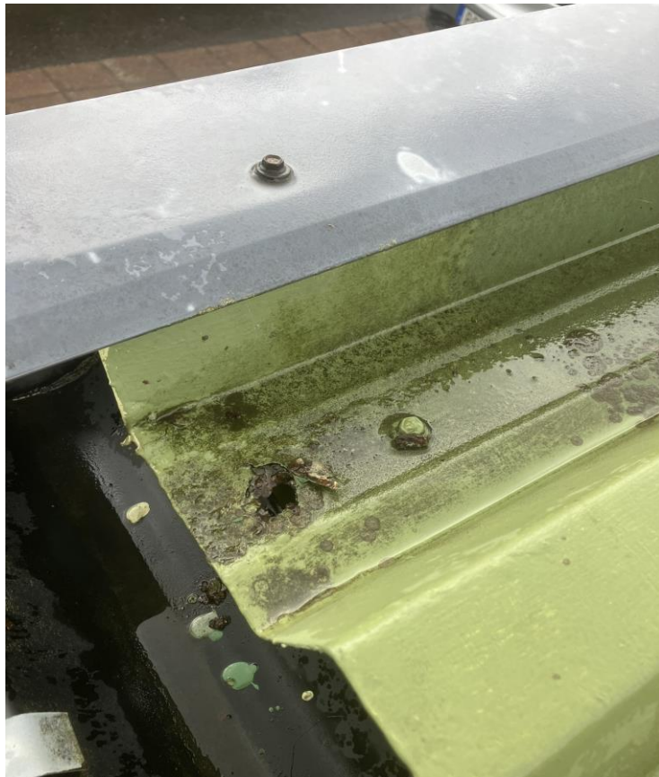
Korrosionsskador i taksprång, bild 2.
