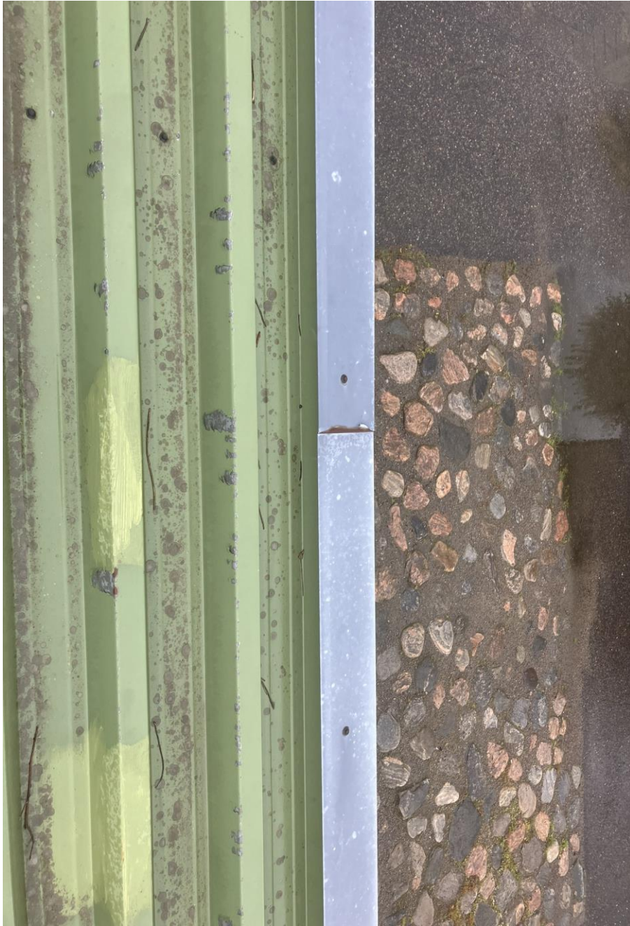
Färgsläpp och vissa korrosionsskador på hängskivor, bild 5.
