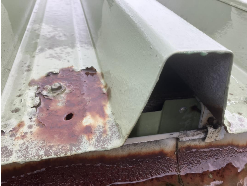
Skador i plåt och hängränna, bild 3.
