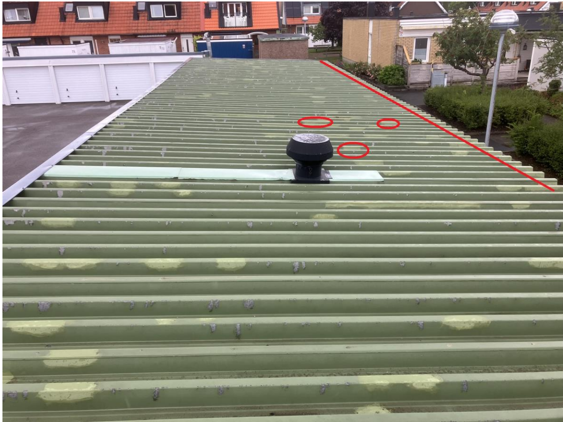
Generellt målade taksprång samt exempel på bättringsmålning, bild 1.
