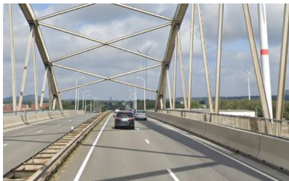
Figuur 22: Dwarsdoorsnede Westerring N76: brug Albertkanaal richting Hasselt (links) en richting Genk (rechts)
