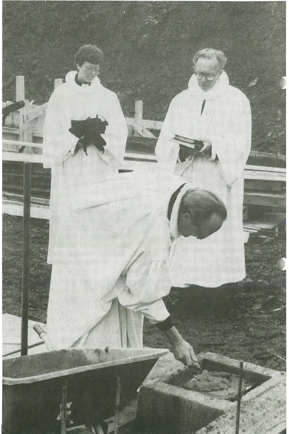
Biskop Kristen Kyrre Bremer legger ned grunnsteinen til det nye Mostadmark kapell. Vitner til den høytidelige anledningen er sokneprest Kjell Fosse (t.h.) og kallskapellan Hanne C. Hoff.
