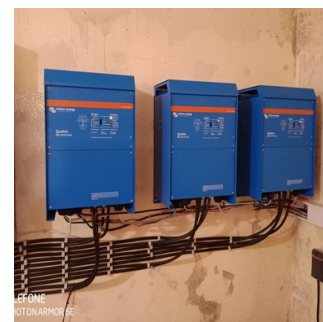
de "gamle" 3x10KW Invertere
